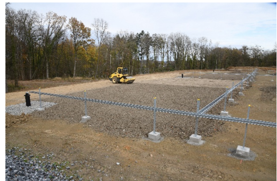
Réseau de puits de pompage des lixiviats.
