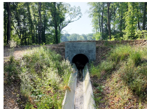
Conduite d'eau reliée au plan d'eau.
