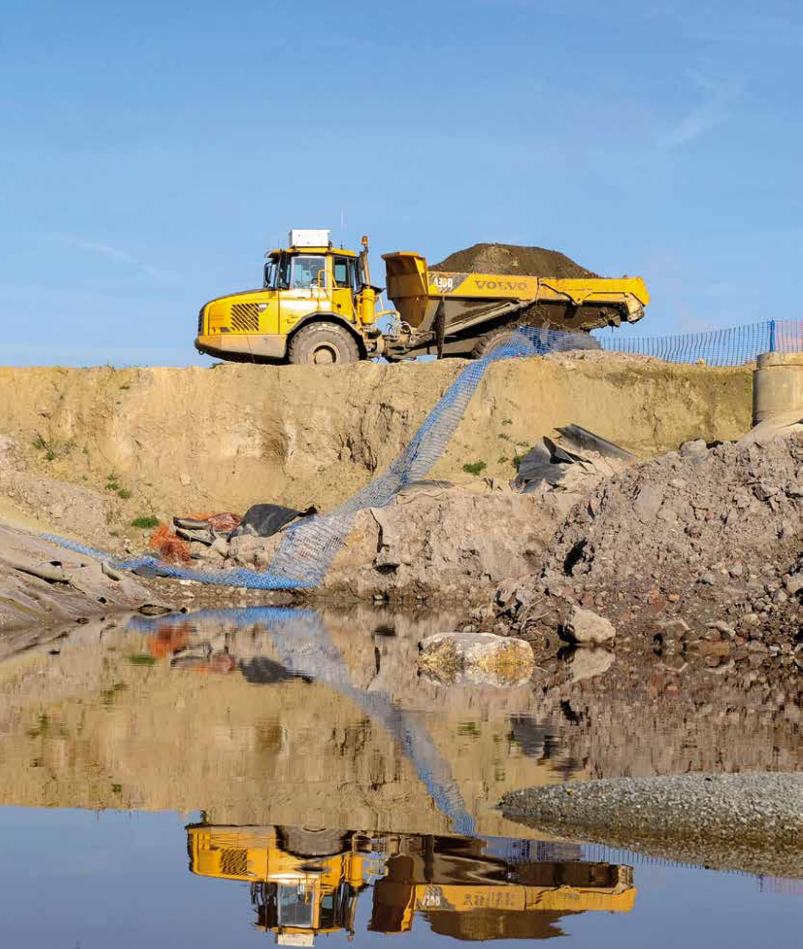
Sur le nord du site « Carcoke Tertre », le reste ayant été réhabilité, une zone de confinement est créée pour contenir une importante contamination en métaux lourds, cyanures, benzène, huiles minérales, HAP, amiante, etc.
